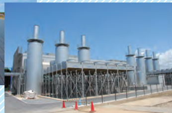
袖ヶ浦グリーンパワー▼ 110MW
