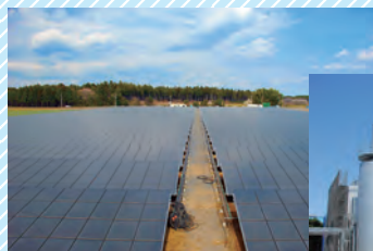
▲いばらき太陽光発電所 2MW
